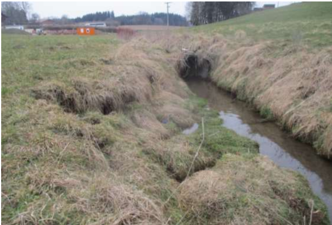
Eisenbach mit Uferabbrüchen
